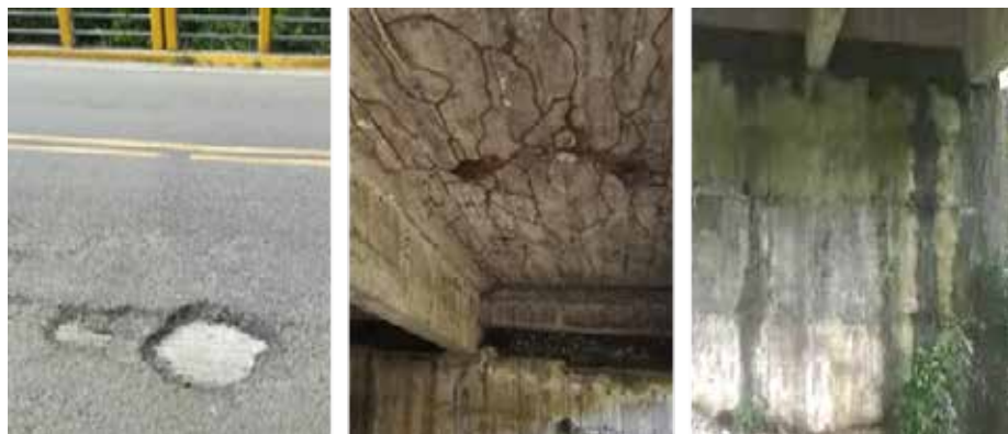
Figura 9. Baches en capa de rodadura, fisuras en la parte inferior del tablero y presencia de humedad y biodegradación
