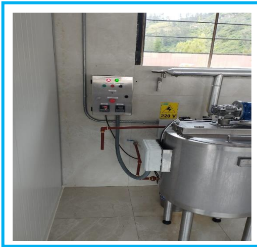
Foto sistema eléctrico industrial taller de Lácteos
